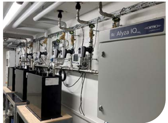
Abb. 3, oben: Der Grauwasserrecycling-Raum mit 2-stufiger biologischer Reinigung und UF des Grauwassers
